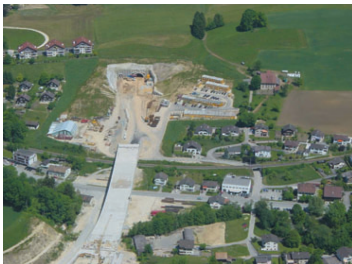
Photos 5 et 6 Excavation du portail de Moutier Excavation of the Moutier portal
