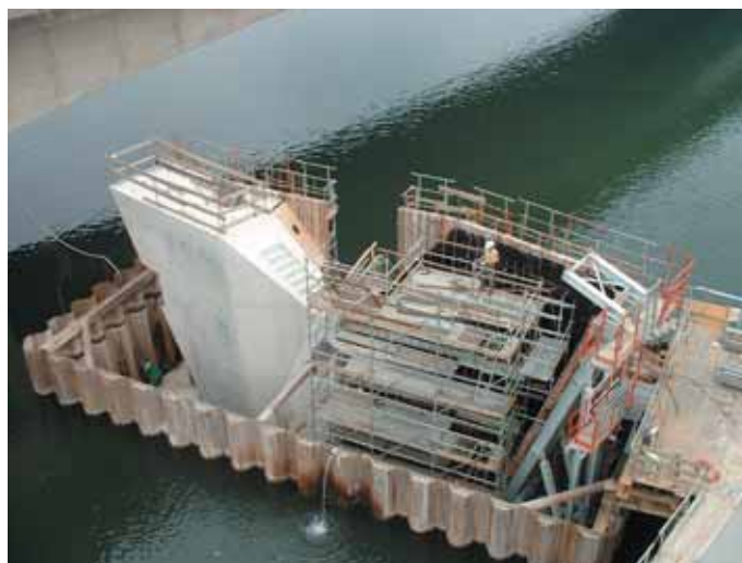
Photo 3 Réalisation d'une pile en Seine Construction of a pier in the Seine
