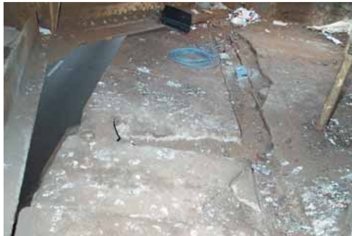
Photo 1 Fissure sur culée Crack on abutment
