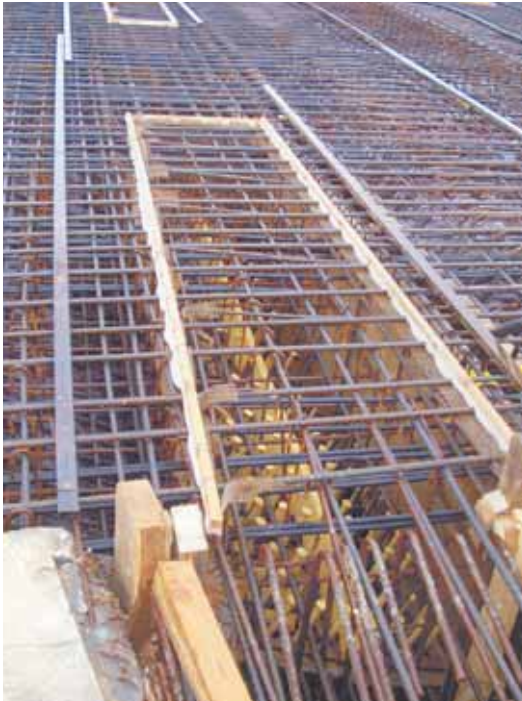
Figure 25 Empochement avant bétonnage du plot sur arc Pocketing before concreting the support on the arch
