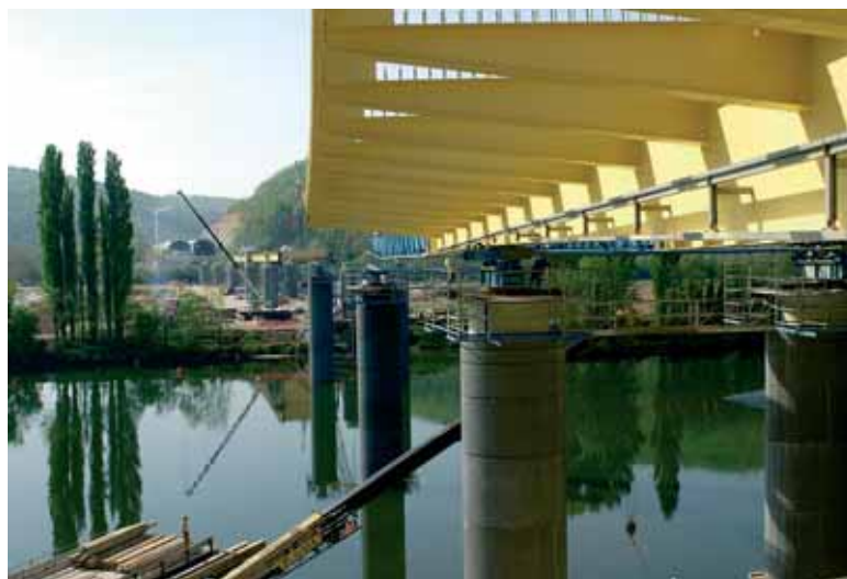
Photo 5 Lancement de la charpente métallique avec son avant-bec, vue de la rive droite Launching the steel structure with its launching nose, view from the right bank
