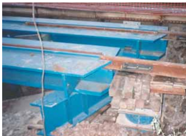
Photo 9 Raccordement de la voie et la poutre de roulement Connecting the track and the running beam
