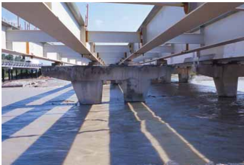
Vue de la structure quadri poutres pendant la crue de la Drôme
