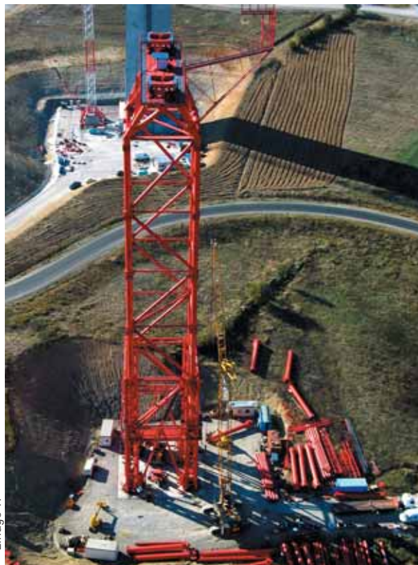
Photo 5 Palée provisoire \pi 4 en cours de montage Temporary bent \pi 4 undergoing assembly
