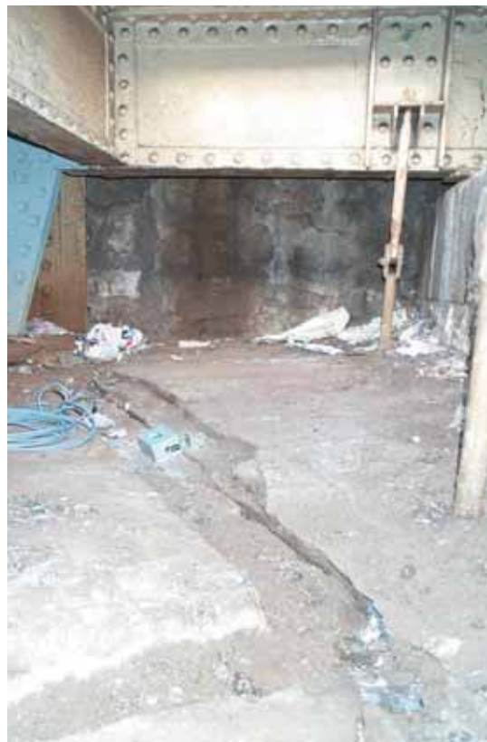
Photo 2 Fissure sur culée Crack on abutment
