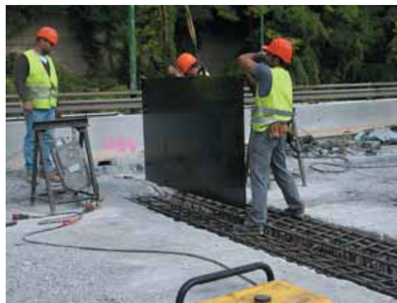
Photo 8 Mise en place du coffrage de la poutre de retombée Installing formwork for the downstand beam
