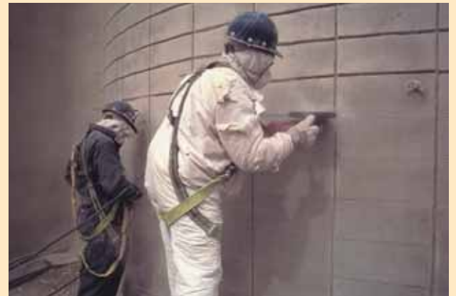
Exemple 5 Réparation de six silos de stockage de ciment au moyen de barres en FRP Innovative technology for the upgrade six cement storage silos with FRP rods
