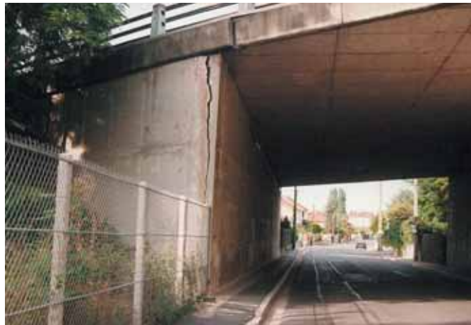
Photo 2 Fracture du pont d'Épinay Fracture of Epinay bridge
