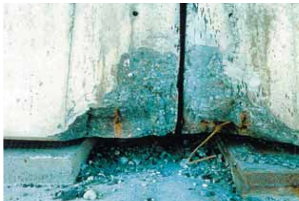
Talons de poutres en butée sur la pile P7 en 1981 Girder bottom flanges bearing against pier P7 in 1981
