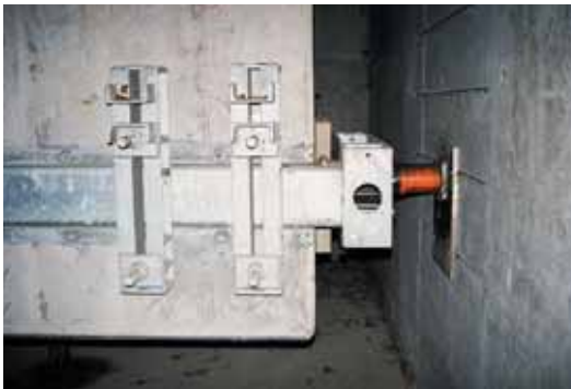
Détail d'un vérin latéral contre l'enceinte périphérique Detail of a lateral jack against the peripheral enclosure wall
