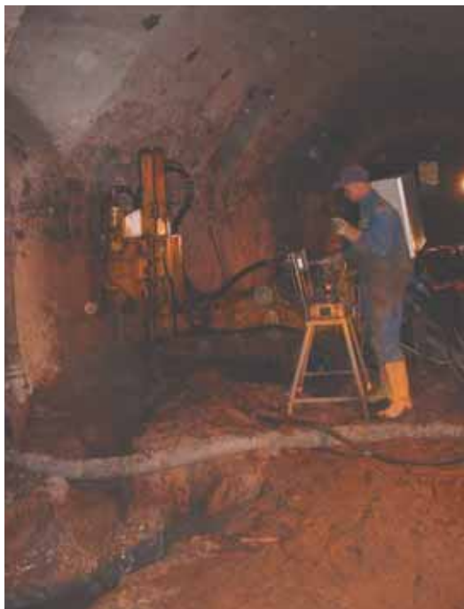
Réalisation d'une colonne de jet grouting Execution of a jet grouting column
