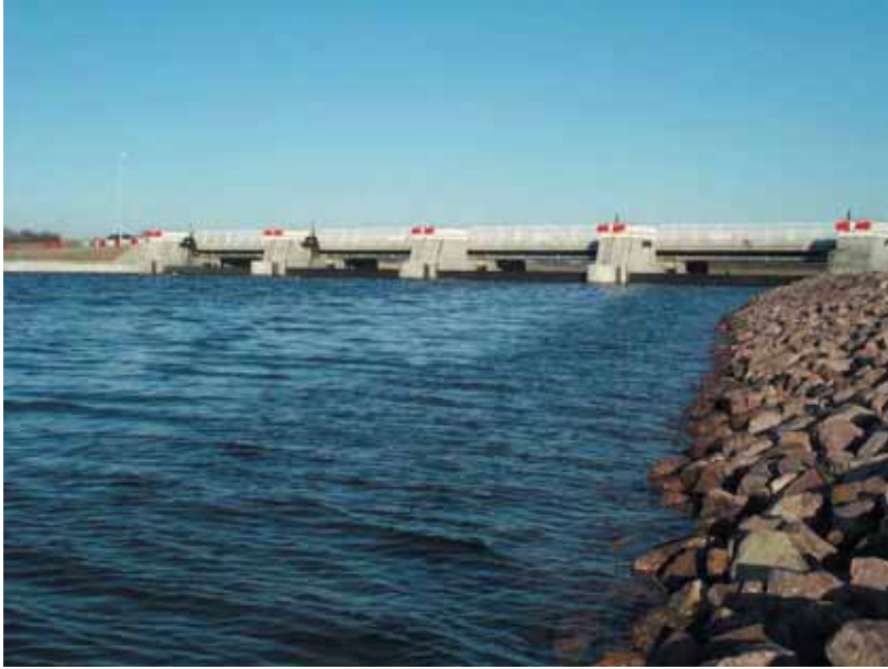
Photo 6 Vue des quatre vannes secteur du Maresquier View of the four Le Maresquier sector valves
