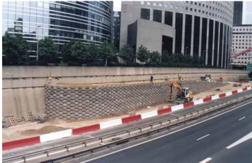
Photo 4 Vue d'ensemble de l'ouvrage en construction Overall view of the structure undergoing construction
