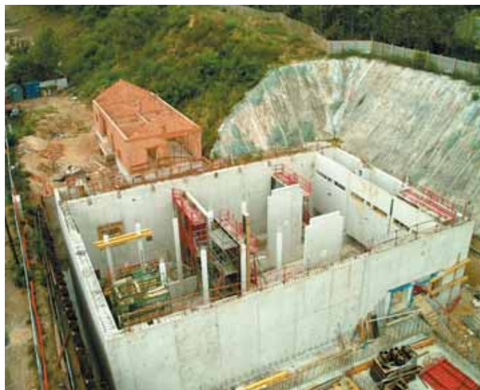
Prétraitement et local d'exploitation Pretreatment and operation room
