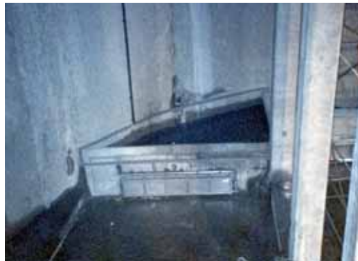
Photo 5 Bassin de stockage de Deauville - Utilisation de clapets de chasse pour nettoyer le fond du bassin
