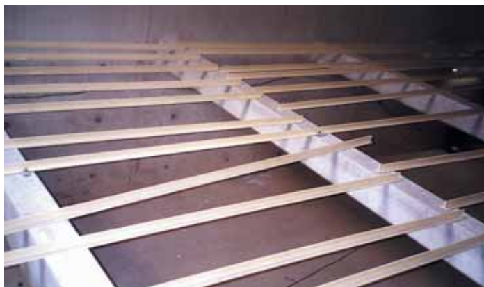
Vue des supportages des modules lamellaires View of lamellar module supports
