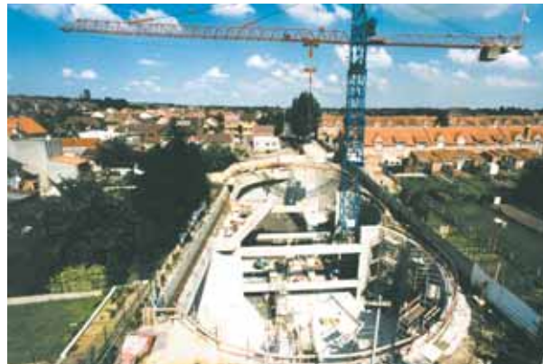
Photo 4 Bassin de stockage "tri-lobes" - Communauté d'agglomération de Lens-Lievin, bassin Pasteur "Triple-lobe" storage tank - Lens-Lievin inter-municipal association ("Communauté d'agglomération") - Pasteur tank
