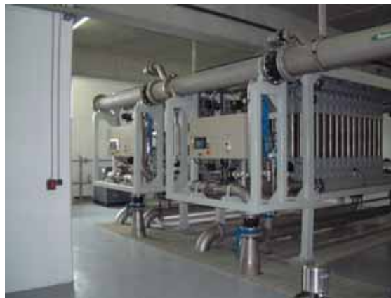
Production de 4 500 m 3 /j d'eau potable par microfiltration tangentielle Production of 4,500 cu. m/day of potable water by tangential microfiltration
