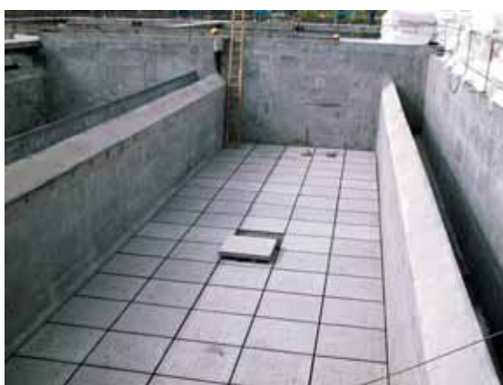
Photo 11 Un filtre avec toutes ses dalles A filter with all its slabs
