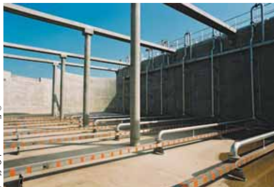
Vue des bassins d'aération - Août 2002
