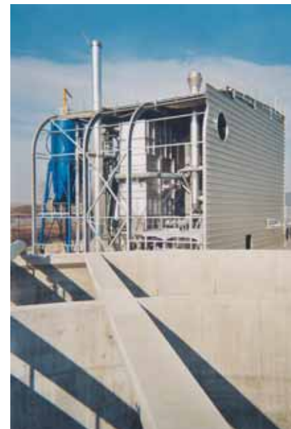
Four d'incinération des boues d'épuration - Février 2003
