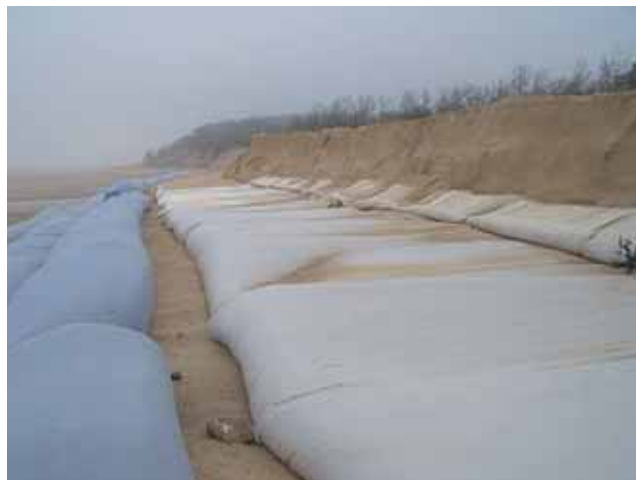
Figure 9 Brise-lames nord en tubes (à gauche) et dune (à droite) avec géotextile de renforcement (au milieu) après la première tempête
