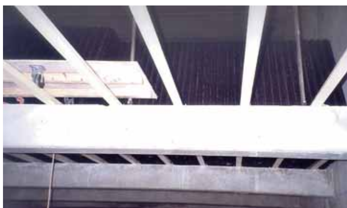
Vue de dessous d'un ensemble supports + lamelles Bottom view of a supports + lamellar plates assembly
