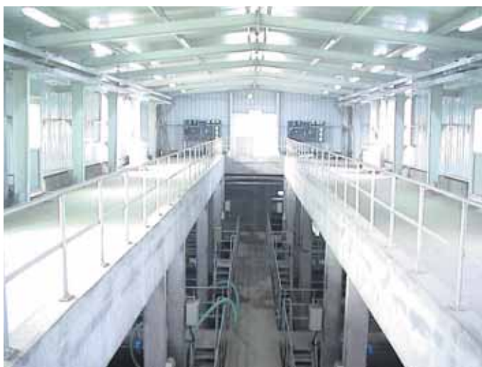
Photo 7 La galerie centrale des filtres
