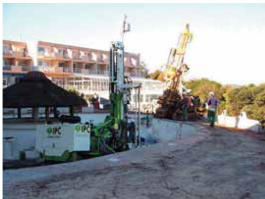
Photo 5 Foreuses à poste Drill stations
