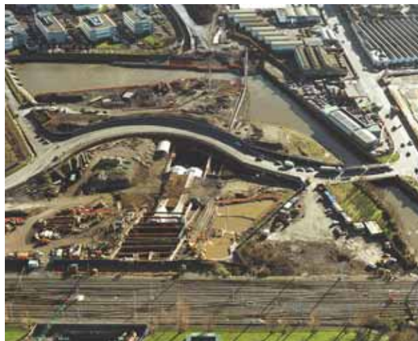
Photo 4 Secteur sud : Alfye Byrne inséré entre la route, la rivière Tolka et la voie ferrée. Réalisation de la structure définitive dans la tranchée maintenue par les parois moulées butonnées
