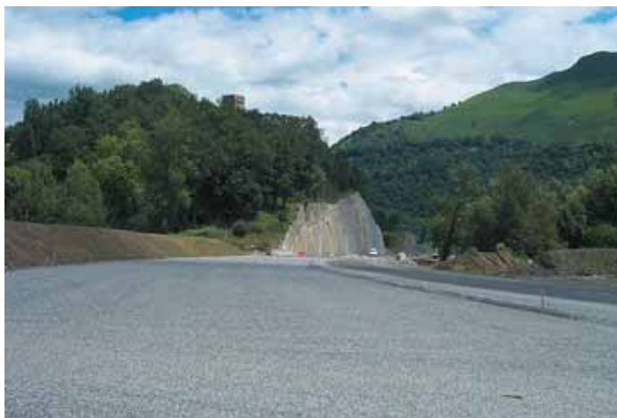
Construction d'une tranchée couverte au pied de la butte de Vidalos Construction of a cut-and-cover at the foot of the small Vidalos hill
