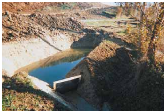
Photo 1 Bassin de décantation équipé d'un filtre à fines (A66 T1) Settling pond equipped with a fines filter (A66 T1)
