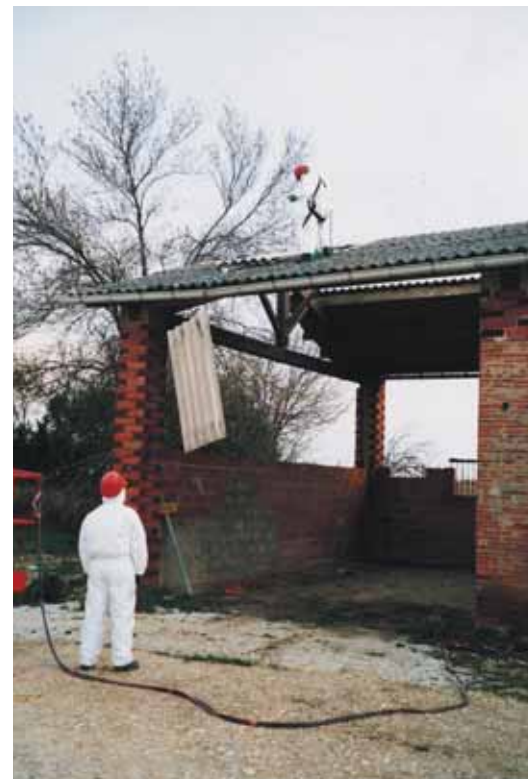
Photo 8 Démontage de plaques d'amiante-ciment par une équipe spécialisée (A66 T1) Dismantling of asbestos-cement slabs by a specialist team (A66 T1)
