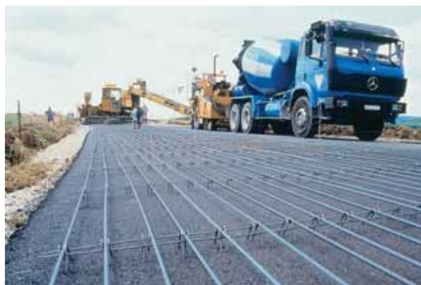
Photo 3 Chaussées composites BAC/GB/réalisation d'un chemin départemental à Maizières (Meurthe-et-Moselle) Composite pavements of continuous reinforced concrete/bitumen treated base material : construction of a county road at Maizières (Meurthe-et-Moselle region)
