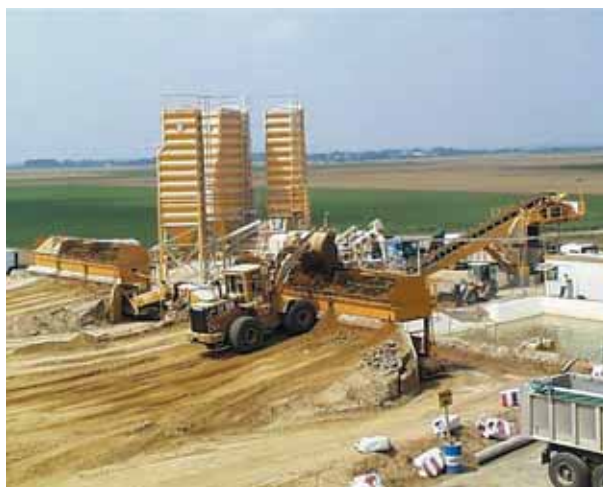
Photo 3 Centrale de traitement du sable Sand treatment plant
