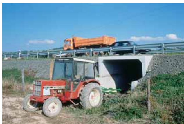
Photo 6 Ouvrage en béton pour faciliter le passage des chevreuils et des sangliers Concrete structure to facilitate the crossing of deer and wild boars
