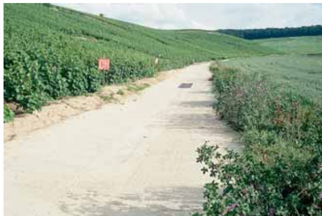
Photo 12 La voirie viticole en béton pour une double fonction : viabilité et fonction hydraulique The viticultural road system of concrete for a twofold function : practicability and hydraulic function
