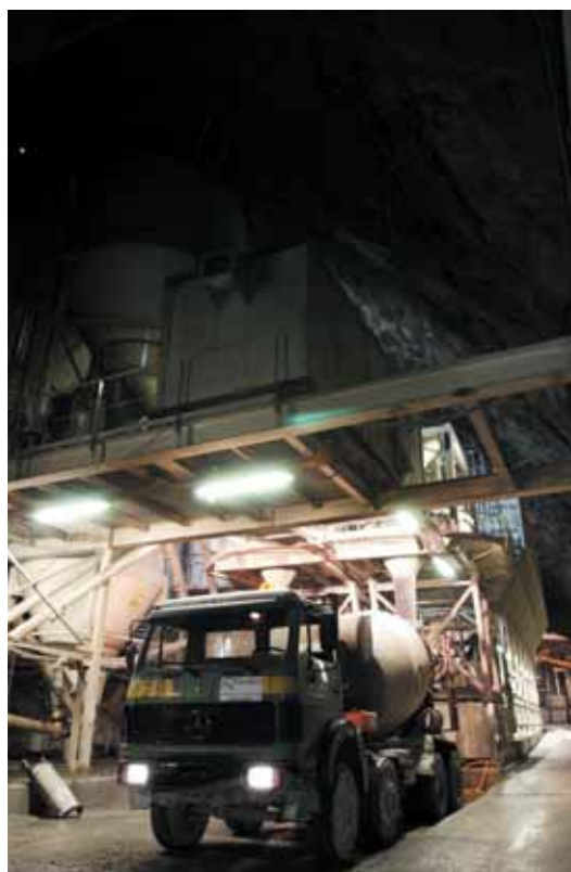
Photo 1 Centrales à béton installées dans la caverne Concrete mixing plants installed in the cave
