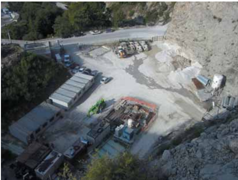
Photo 7 Vue d'ensemble de l'installation General view of the installation
