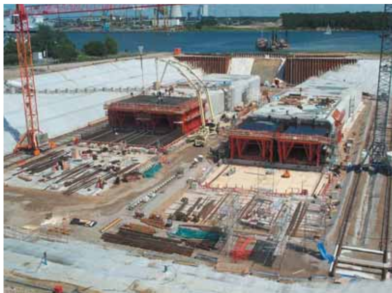
Fabrication des caissons 1 et 2 dans la darse Manufacture of caissons 1 and 2 in the dock
