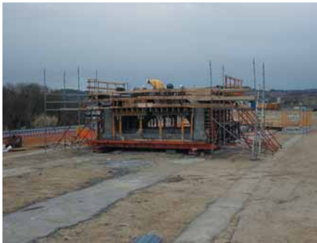
Photo 4 Vue d'ensemble du coffrage du voussoir sur pile au démarrage de la construction du fléau. Au premier plan, les longrines d'appui des coffrages
