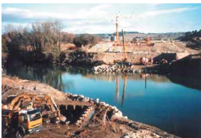
Photo 10 Vue d'ensemble du chantier : réalisation des plates-formes de travail pour l'exécution des appuis, des batardeaux de palplanches et des pieux de fondation des piles. En arrière plan, préparation de l'aire de préfabrication du tablier
