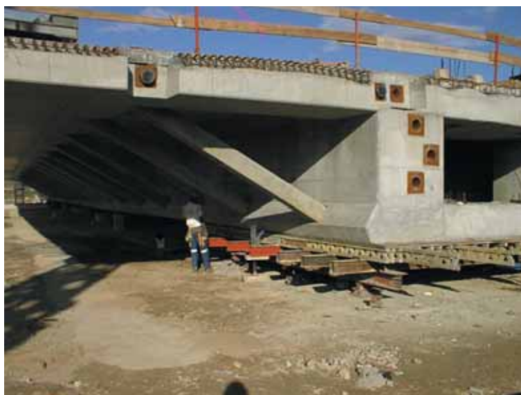
Photo 7 Réalisation du dernier voussoir du fléau, le voussoir sur culée, encore appuyé sur son fonds de moule Construction of the last segment of the deck section, the segment on abutment, still supported by its mould bottom
