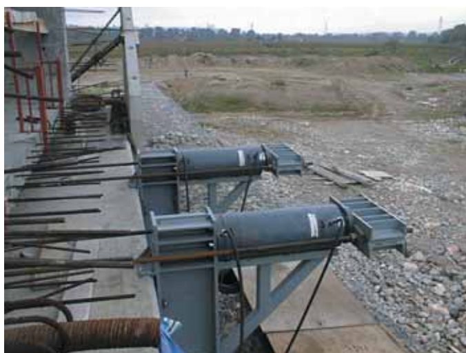
Photo 8 La paire de vérins hydrauliques permettant d'assurer le poussage du tablier par traction sur les barres The pair of hydraulic cylinders making it possible to perform deck pushing by drawing on the bars
