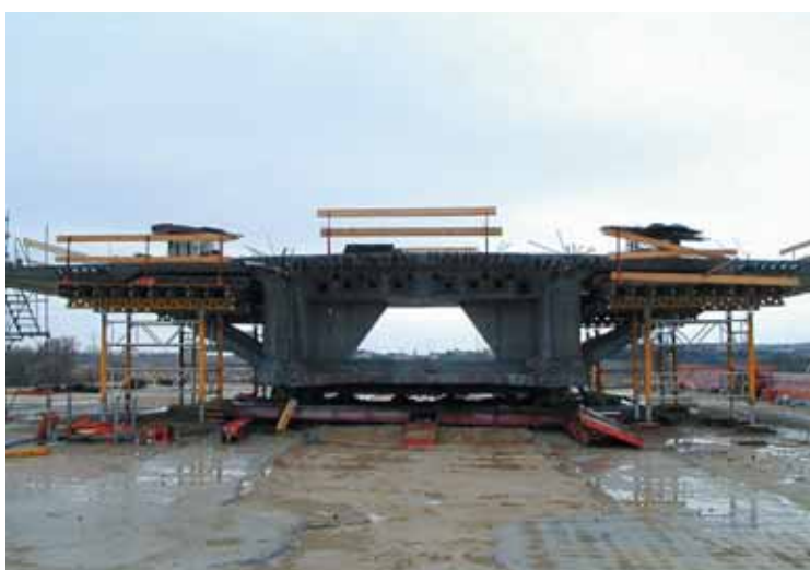
Photo 5 Premier voussoir sur pile décoffré First segment on pier with shuttering removed
