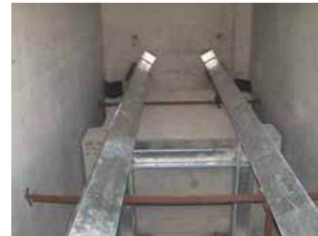
Photo 4 Casemates : charpente métallique galvanisée accueillant les conteneurs Storage Modules : Galvanized Steel Cradle for Canisters
