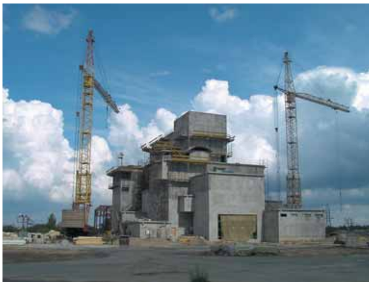
Photo 10 L'usine de conditionnement. Vue d'ensemble The Processing Plant : General View
