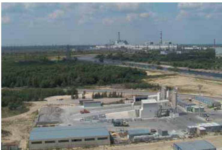
Photo 2 Installations de chantier : les centrales à béton Site Installation : the Concrete Batching Plants
