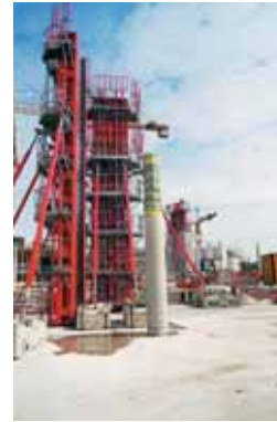
De gauche à droite : pilier de hauteur 16 m partiellement décoffré - Coffrage de pilier avec bâche pour le confinement - Coffrage des piliers de la tribune est, hauteur 11 m
