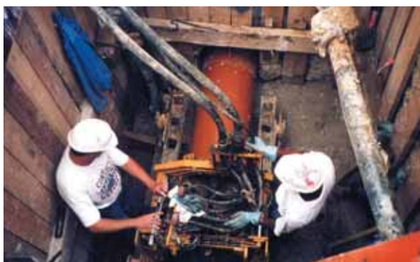
Photo 4 Réalisation d'un forage destructif, mise en œuvre des tuyaux PVC Ø 500 mm (Nogent-sur-Marne)
