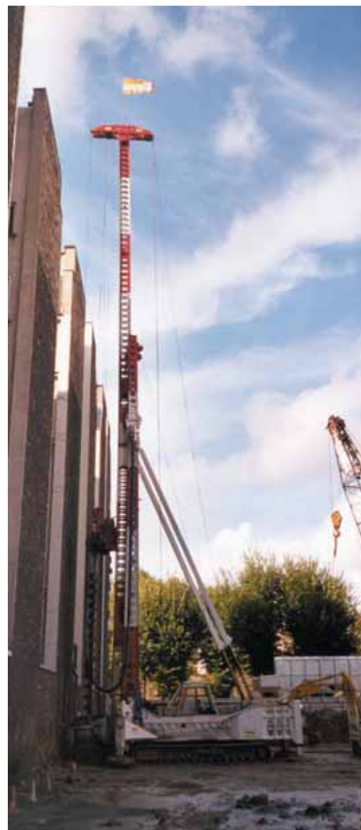
Photo 4 Réalisation de pieux de confortement de 30 m à la tarière creuse le long de mitoyens Execution of 30-metre consolidation piles by hollow auger along the adjoining buildings
