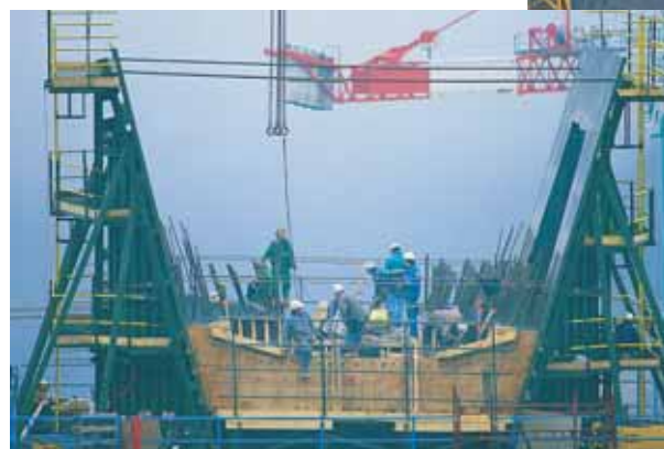
Coffrage du voussoir sur pile P5 (vue rapprochée) Shuttering of segment on pier P5 (close-up view)
