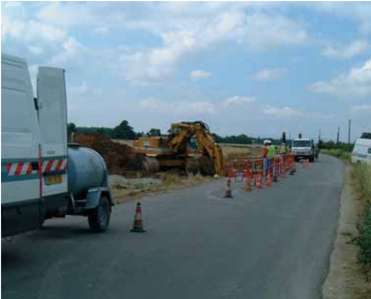
Tranchée en accotement sur voie communale Trench on the road shoulder on a communal road
