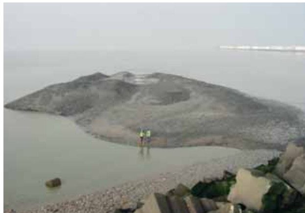
Photo 7 Le soubassement avant tout réglage à la pelle The base before any levelling by shovel
