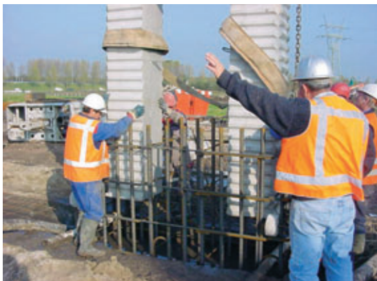
Photo 3 Liaisonnement des poteaux d'ancrage du béton immergé avec la cage d'armature Linking the anchorage columns of the submerged concrete with the concrete reinforcing cage
