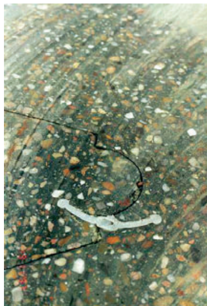
Photo 3 Mise en évidence du joint water-stop par découpage du béton de paroi moulée (brevet Spie Fondations)
