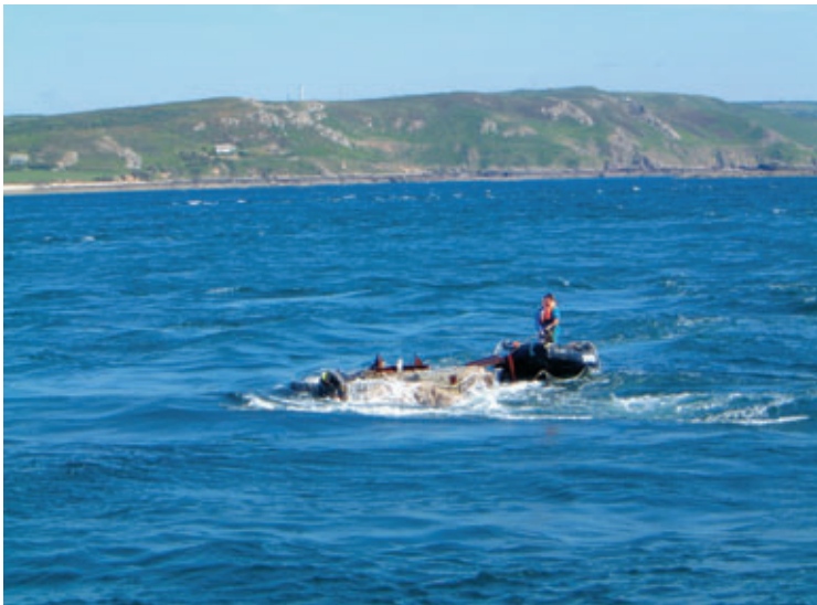
Photo 1 L'écueil déjà équipé du centreur de coffrage The reef already equipped with the formwork centring device
