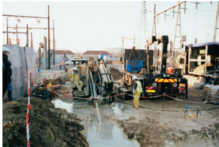
Mise en place d'un fourreau pour câble électrique 90 kV. Atelier de forage
