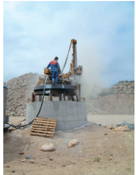
Photo 4 Validation à terre de la procédure de forage Validation of the drilling procedure on land
