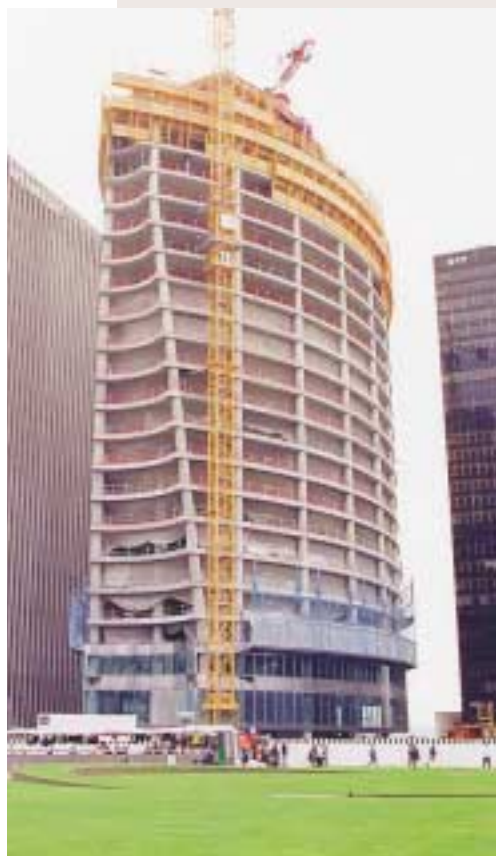
Photo 6 Les poteaux inclinés Inclined columns
