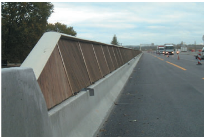
Photo 4 Ecrans acoustiques montés sur dispositifs GBA Noise barriers mounted on concrete safety barriers
