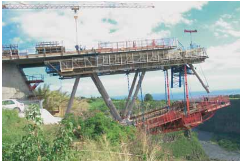
Démarrage encorbellement (V2) côté rive gauche Start of cantilevering (V2), left bank end
