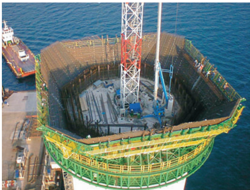
Photo 8 Photo la plus récente du chantier. Les 2/3 inférieurs du coffrage extérieur et le début du ferrailage du chevêtre
