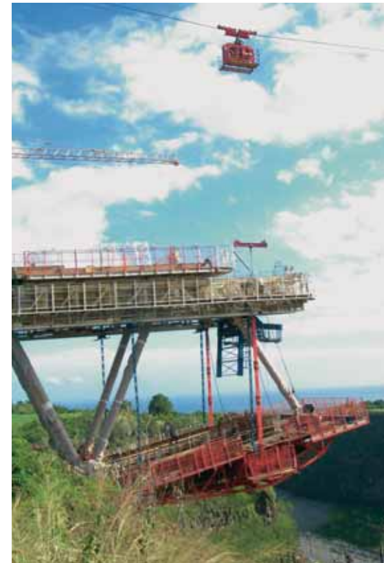
Vue encorbellement (V2) côté rive gauche - Blondin View of cantilevering (V2), left bank end - Blondin
