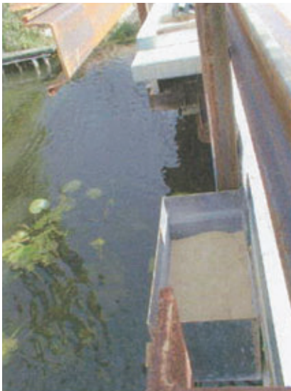
Photo 3 Boîte filtrante de l'estacade Breakwater filtration canister
