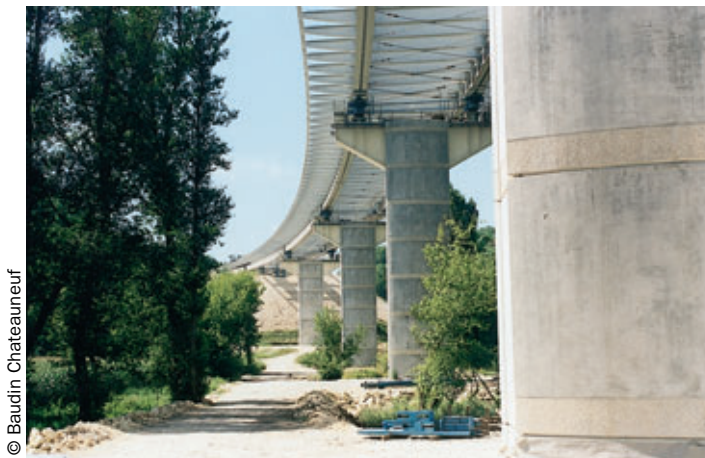
Photo 7 Vue des piles terminées avec l'ossature du tablier en cours de lancement View of the completed piers with the deck frame being launched
