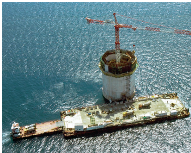
Photo 7 Le fût de la pile M3 en cours de réalisation avec la barge support et la barge Saroula servant au transport des toupies The shaft of pier M3 undergoing construction with the support barge and the Saroula barge used to transport the concrete mixer trucks
