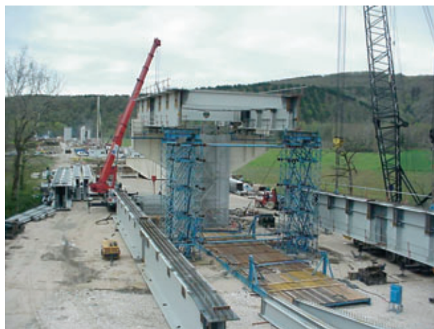
Photo 14 Montage à la grue du tablier nord Crane assembly of the north deck
