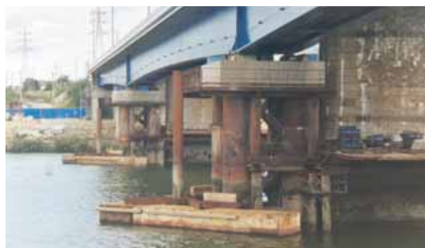
Photo 5 Les piles provisoires P1 et P2 portant le tablier. A l'amont des palées, les protections légères contre les chocs de bateaux de plaisance Temporary piers P1 and P2 carrying the deck. Upstream of the bents, light structures for protection against pleasure boat impacts
