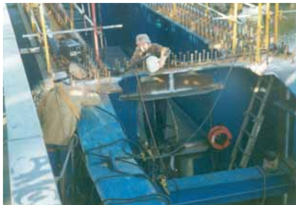
Photo 8 Assemblage sur chantier des tronçons de poutres. Joint entre demi-pièces de pont On-site assembly of girder sections - Joint between bridge halves
