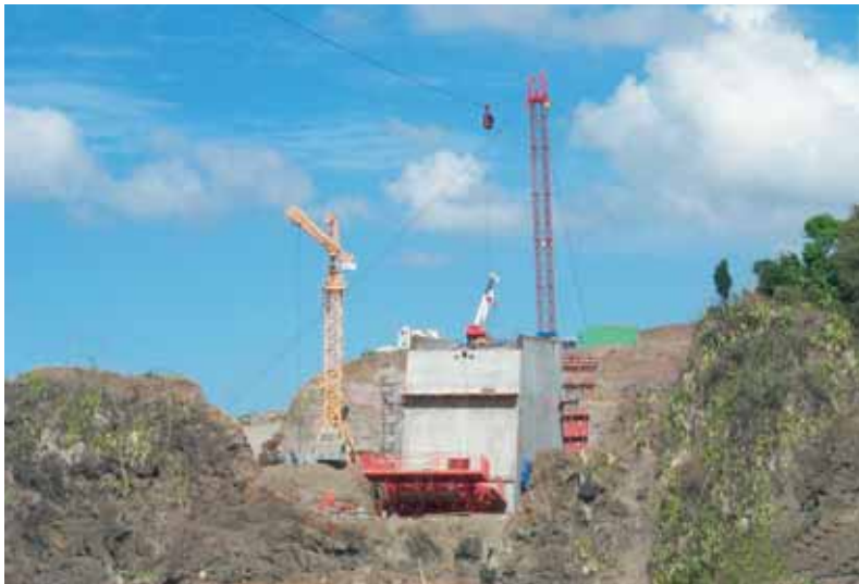
Vue de la culée rive droite View of abutment on right bank
