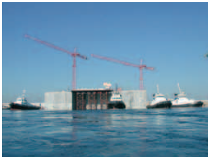
Photo 11 Départ de la culée du port de Marseille Departure of abutment from Port of Marseilles
