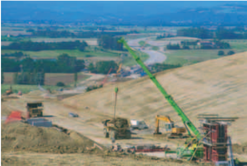
Photo 1 Déblai du TOARC 1 et vue sur la vallée de l'Ariège Cuttings of project Phase 1, and view of Ariège valley
