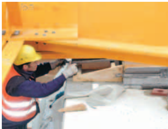
Photo 6 Détails des selles de glissement (l'opérateur introduit une plaque Néoprène - Téflon® entre la selle et l'avant-bec) Details of sliding saddles (the operator inserts a Neoprene-Teflon® plate between the saddle and the cutwater)
