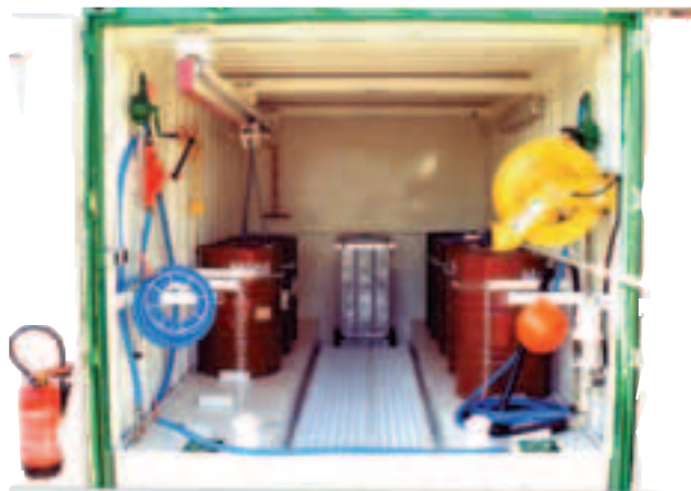
Photo 7 La plus grande partie du conteneur dont le sol est recouvert par un bac de rétention Largest part of container with retention pan on floor
