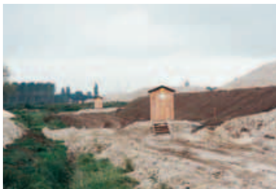
Photo 2 Cabines de mesures sur chantier Measurement cabin on site
