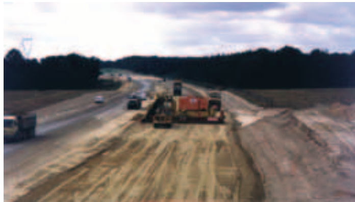
Photo 4 Découpe à l'autograde de la couche de forme. Les matériaux rabotés sont récupérés pour être réutilisés sur le TPC Subgrade cutting with autograder. Planed materials are recovered for reuse on median
