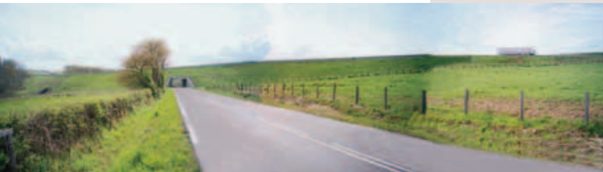
Photo 5 Vue d'ensemble du remblai achevé côté est Overall view of completed embankment on east side
