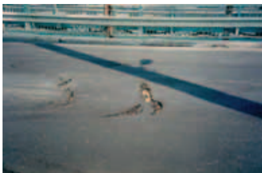
Photo 9 Déchirement de l'enrobé conventionnel après deux semaines Tearing of conventional mix after two weeks
