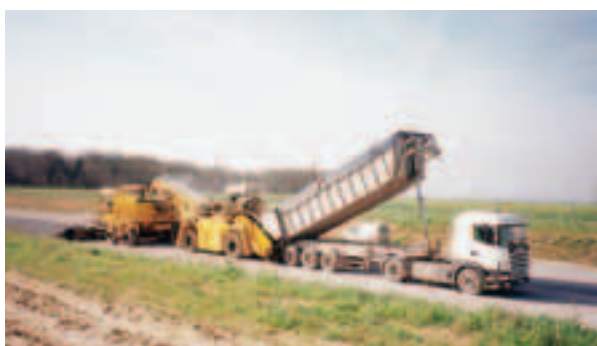
Photo 6 Vue d'ensemble de l'atelier de mise en œuvre (finisseur Vögele S 2500 et alimentateur Franex) General view of the manufacturing plant (Vögele S 2500 paver and Franex feeder)
