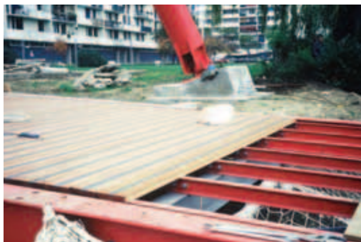
Mise en œuvre du platelage en bois exotique muni de bandes rugueuses antidérapantes et usiné selon la technique anti-vertige Tropical hardwood flooring with non-slip strips, designed to offset fear of heights
