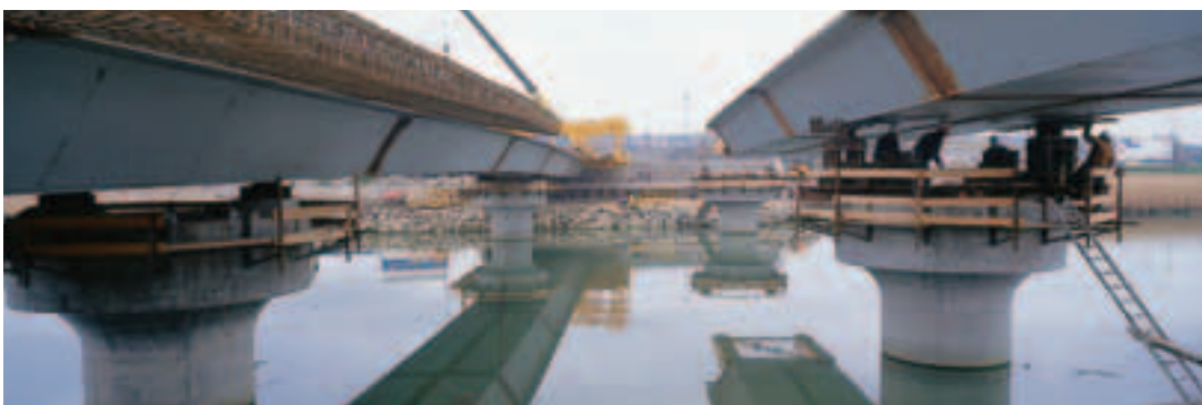
Dispositifs de glissement des structures métalliques des tabliers
