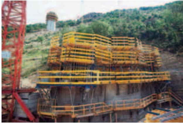
Outil coffrant des piles réalisé par la société Doka (en position à la base de la pile P2)
