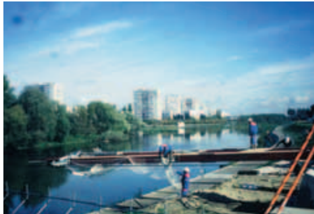
Début des opérations de lancement du tablier métallique Start of steel deck launching operations
