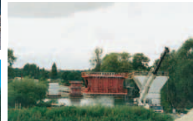
Vue générale des deux coffrages en place General view of shuttering in place
