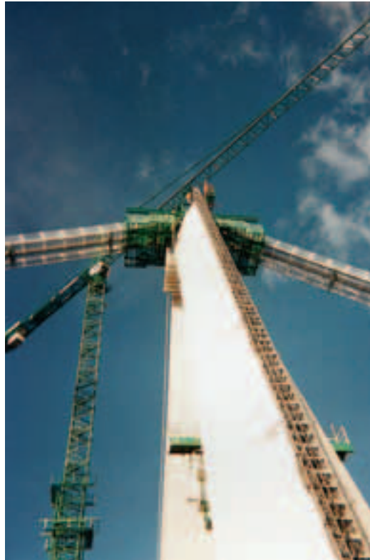
Viaduc du Chavanon sur l'A89. Pylônes en B80 coulé dans des coffrages préfabriqués en B50 polis
