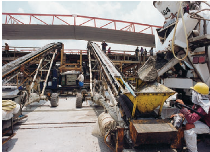
Figure 15 Placing of concrete for D6 segments Mise en œuvre du béton pour voussoirs D6
