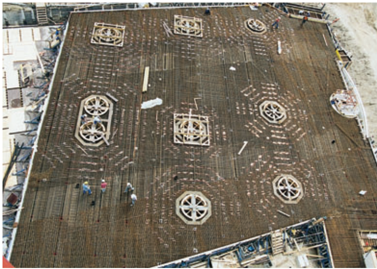
Photo 5 Ferrailage de la dalle de toit de la gare du Reichstag Reinforcement of the Reichstag subway station roof slab
