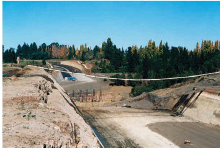
Photo 1 Terrassements dans des terrains rocheux à proximité du pont Laja Earthworks in rocky terrain near the Laja Bridge
