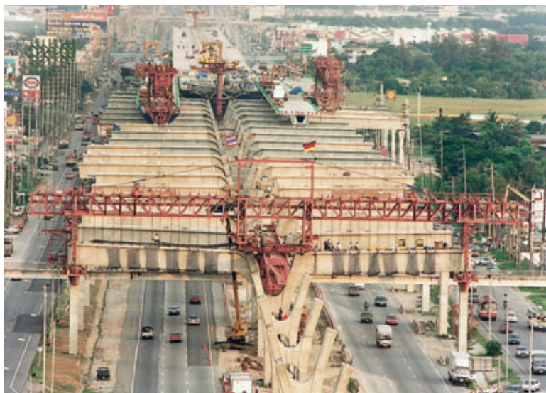
Figure 4 Erection of D6, D2/D3 and portal segments Montage des voussoirs D6, D2/D3 et portiques
