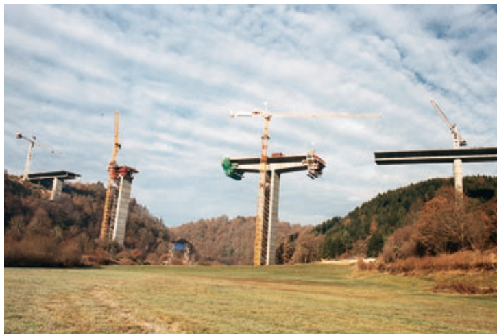
Photo 9 Décembre 1998 - Fléaux 2 et 3 en cours de réalisation December 1998 - Cantilever arms 2 and 3 during construction
