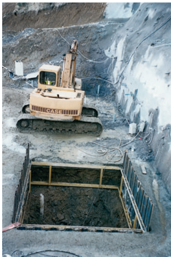
Photo 2 Avant-puits et paroi de la pile P2 Pilot shaft and wall of pier P2
