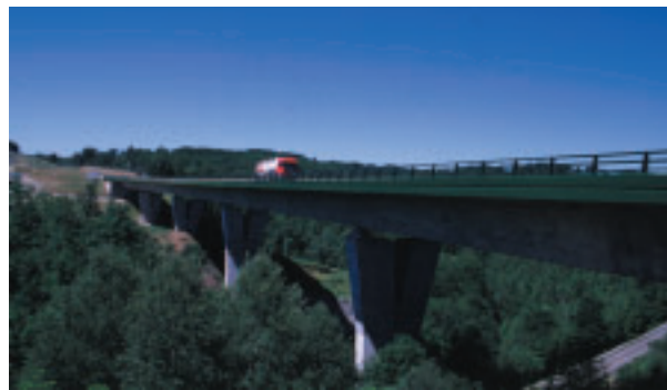
Photo 3 Les piles du viaduc se fondent dans la vallée boisée The viaduct's piers blend with the wooded valley
