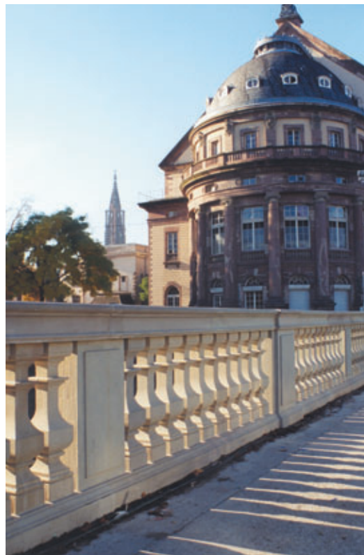
Photo 2 Détail des balustres en grès des Vosges Detail of Vosges sandstone balusters
