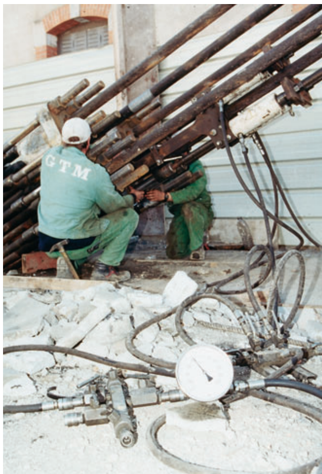
Photo 4 Transfert de charge sur câble de suspension Load transfer on suspension cable
