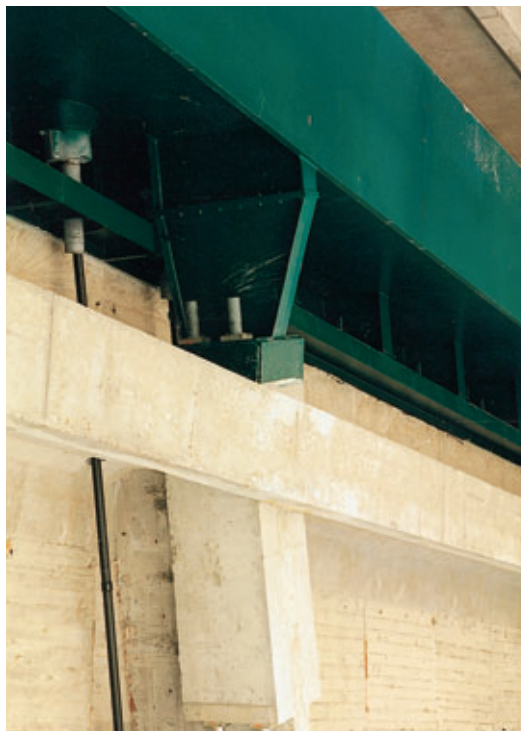
Liaison poutre centrale métallique. Structure existante Link of central steel girder. Existing structure
