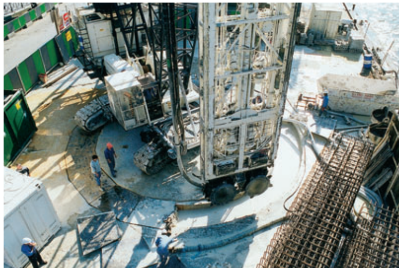
Photo 3 La rotoreuse en train de se mettre en position pour le forage
