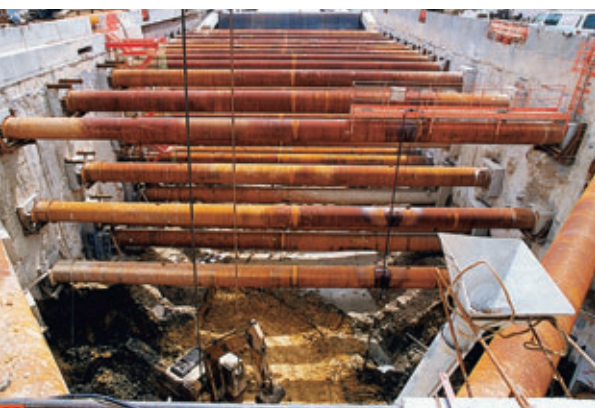
Photo 3 Puits J - Terrassement sous les butons Shaft J - Earthworks under the struts
