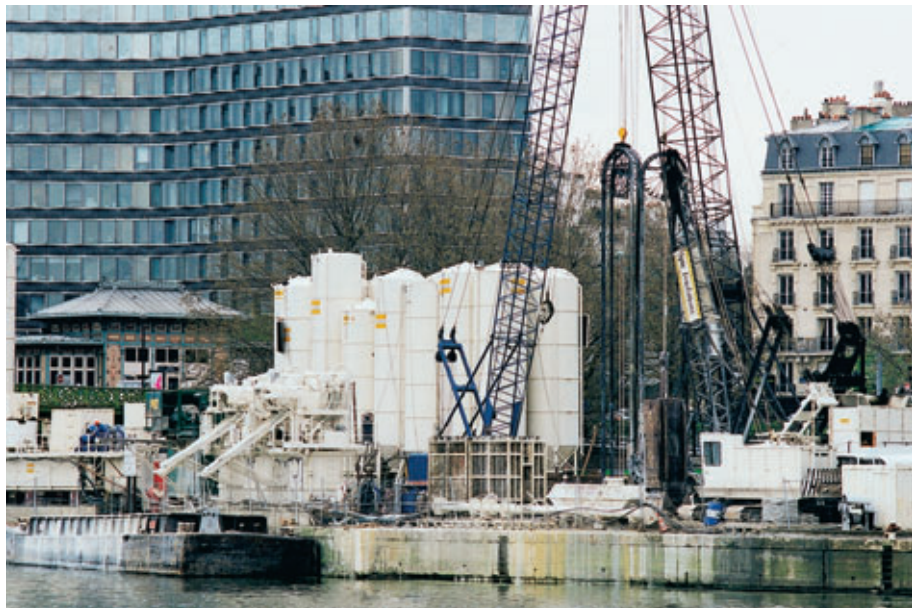
Photo 2 Vue générale du chantier qui montre la compacité des installations qui permet néanmoins l'évolution de trois grues
