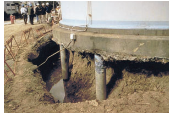
Photo 9 Kobe - Japon (1995) : Poussée latérale sur les fûts de pieux, due à la liquéfaction Lateral pressure on pile shafts due to liquefaction
