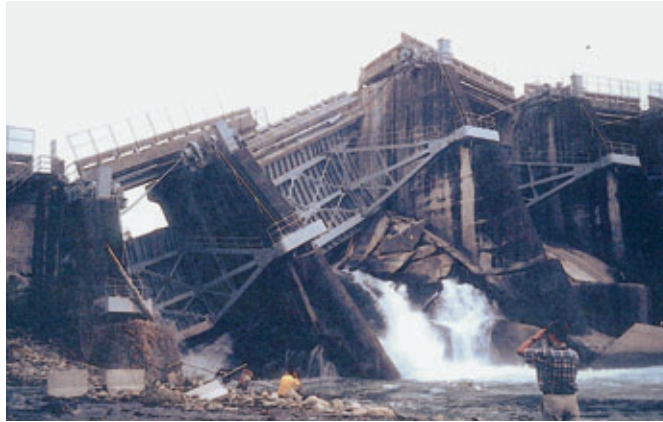
Photo 16 Chi Chi - Taiwan (1999) : Rupture d'un barrage due au rejet de la faille (8 à 9 m) Dam failure due to fault displacement (8 to 9 m)
