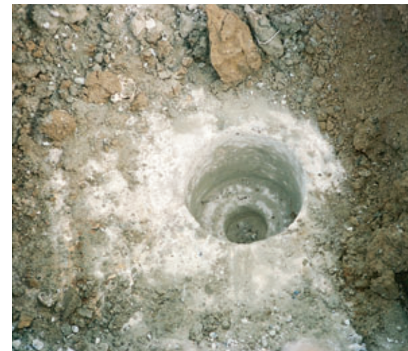
Photo 3 Pénétration de la tarière Starsol dans un massif de béton non armé Penetration of Starsol auger into a non-reinforced concrete mass
