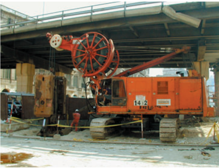
Photo 6 Puits de sortie d'Attaba, paroi moulée en cours de réalisation sous l'autopont Attaba exit shaft, diaphragm wall during construction under the flyover
