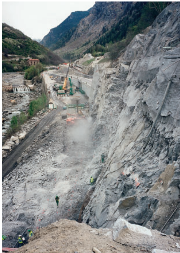
Photo 6 Les terrassements rocheux à l'amont de l'éperon des Sorderettes The rocky earthworks upstream of the Sorderettes spur
