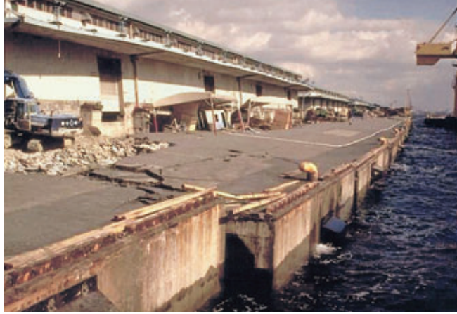
Photo 8 Kobe - Japon (1995) : Liquéfaction : Mouvements latéraux différentiels d'un quai Liquefaction : Differential lateral movements of quay walls
