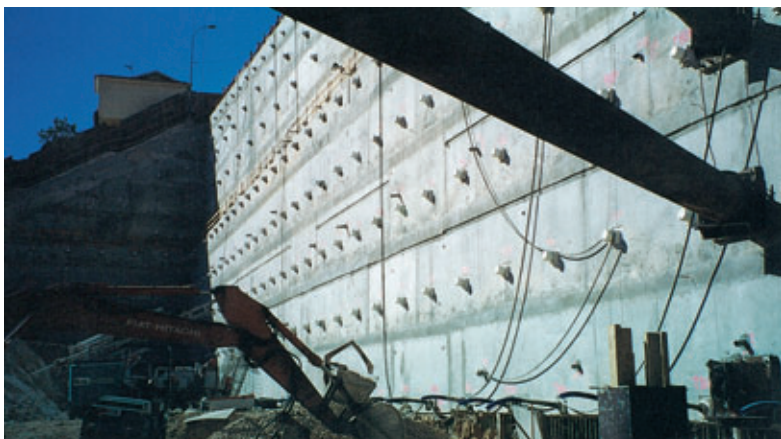
Le fond de fouille est en vue The excavation bottom is in sight
