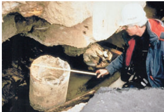
Photo 10 Kobe - Japon (1995) : Rupture d'une tête de pieu Failure of pile cap
