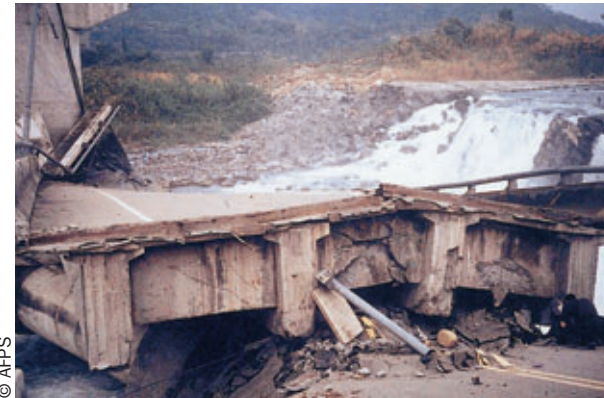
Photo 17 Chi Chi - Taiwan (1999) : Rejet de la faille (8 à 9 m) près d'un pont Fault displacement (8 to 9 m), near a bridge
