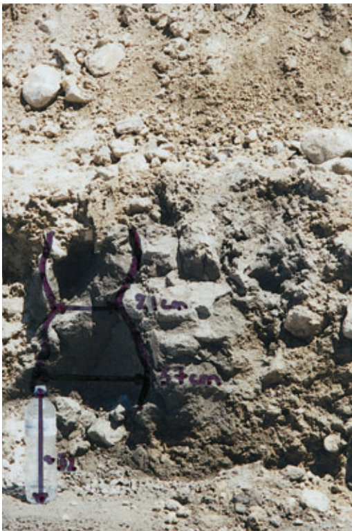
Colonne d'injection en zone de gypse altéré Grouting column in weathered gypsum
