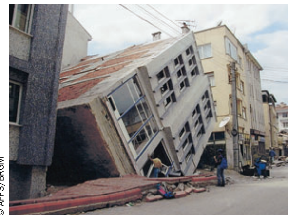
Photo 12 Adapazari - Turquie (1999) : Liquéfaction - Rotation d'un radier Liquefaction - Tilt of mat foundation
