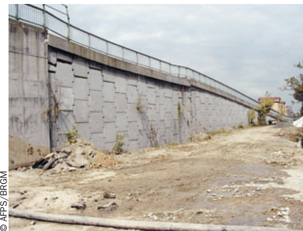
Photo 18 Près d'Adapazari - Turquie (1999) : Bon comportement d'un mur en terre armée situé à 50 m de la faille, en moyenne Satisfactory behaviour of reinforced earth wall located at an average of 50 m from the fault
