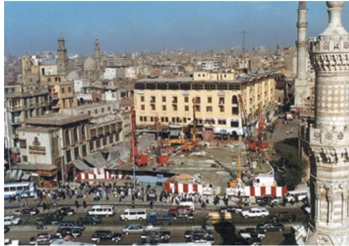
Photo 1 Station d'El Hussein, vue générale du chantier El Hussein station, general view of site
