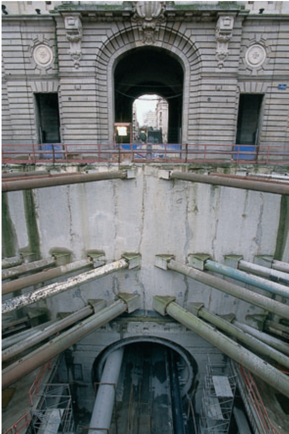
Station République, vue après passage du tunnelier République station, view after passage of TBM
