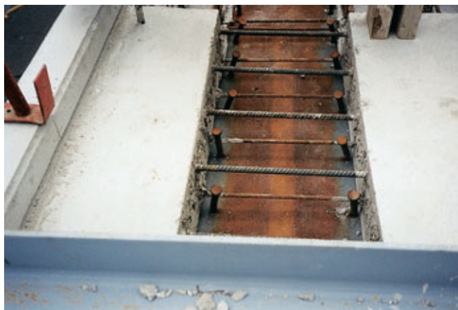
Photo 2 Mise en place des éléments préfabriqués de hourdis Installation of pre-cast slab elements
