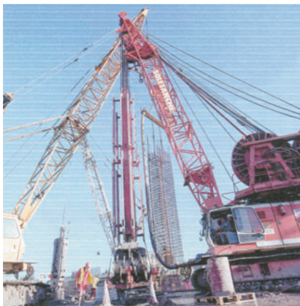
Photo 2 Mise en place d'une cage d'armatures. A côté de l'hydrofraise, la benne pour excaver les terrains supérieurs argileux
