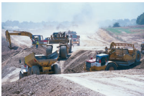
Une équipe de terrassements au niveau de la VC6 sur la commune de Denée
