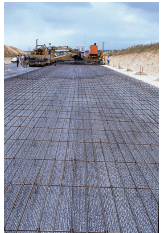
Photo 5 Déviation des Rassats-Favrauds. Avant l'atelier de bétonnage, les armatures du BAC sont positionnées, à mi-hauteur de la dalle béton, au-dessus de la couche de grave bitume
