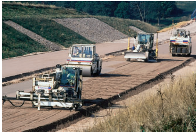
Photo 4 Atelier de mise en œuvre du sable traité Treated sand application plant
