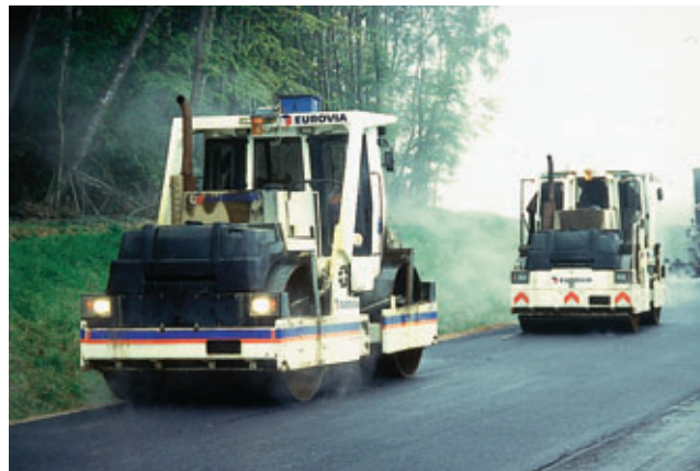
Photo 8 Compacteurs testés dans l'expérimentation de guidage par GPS Compactors tested during GPS-guidance trials
