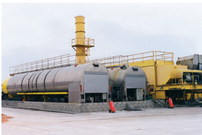
Photo 5 Mesures antipollution autour des cuves de bitume et de fuel lourd
