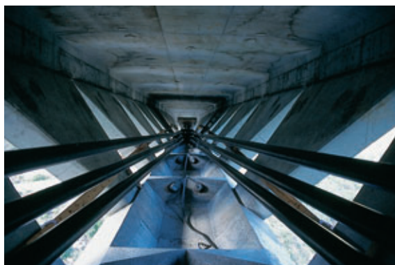
Photo 2 Vue intérieure du câblage extérieur Inside view of outside cabling
