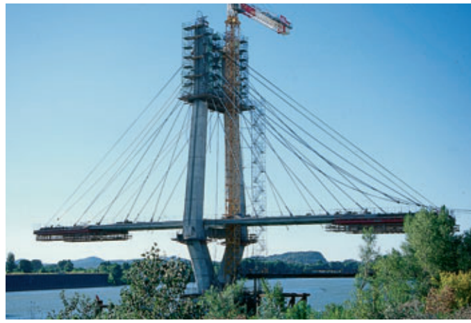
Photo 7 Double encorbellement - Réalisation des voussoirs n° 5 Double cantilever - Completion of segments No. 5
