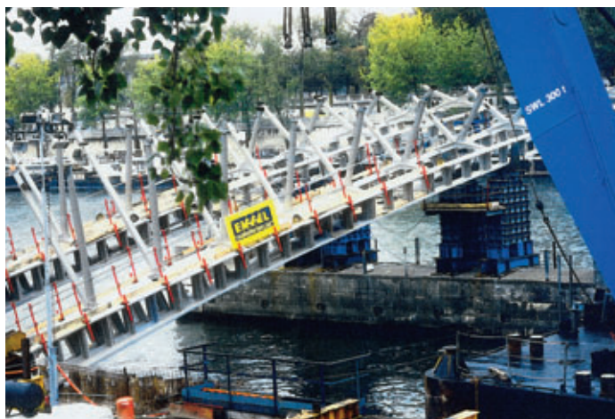
Tronçons de rive côté rive gauche. A droite la ligne de levage de capacité 300 t Left bank sections. On right, 300 t capacity lifting line
