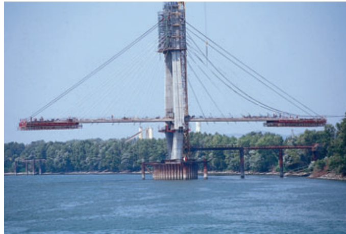
Photo 8 Double encorbellement - Réalisation des voussoirs n° 6 Double cantilever - Completion of segments No. 6
