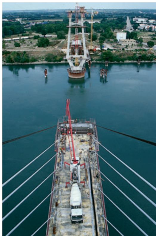
Photo 11 Surencobernement - Vue de dessus Overhand - Top view
