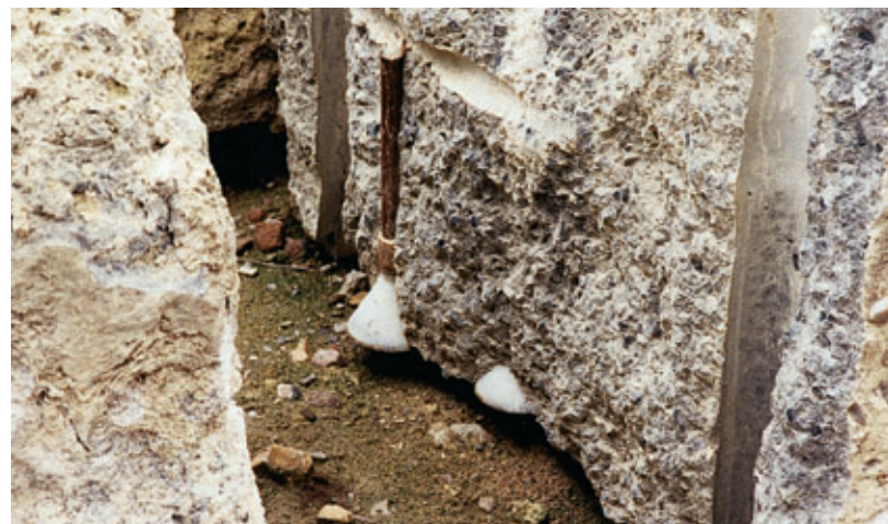
Photo 1 Bloc de béton recépé avec réservoir servant de chambre d'expansion du mortier expansif Cut off concrete block with reservoir serving as a mortar expansion chamber
