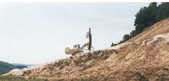
Photo 5 Foreuse dans le déblai de Combe Nègre Drilling machine in the Combe Nègre cutting
