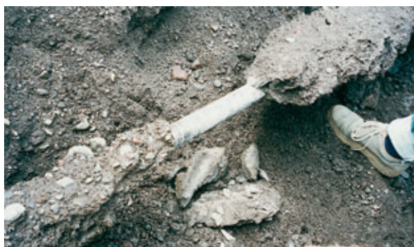
Photo 3 Les clous mis à nu The bared nails
