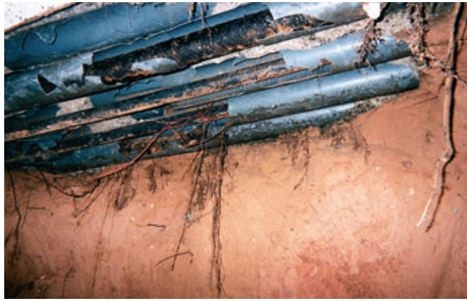
Rencontre d'obstacle imprévu : câbles électriques abandonnés
