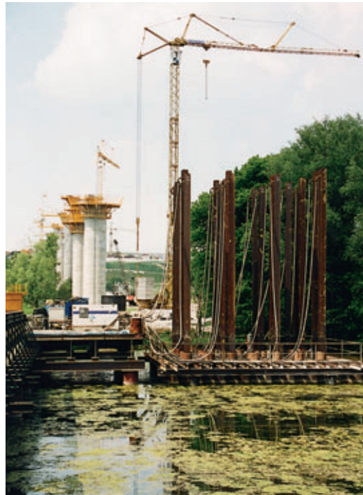
Photo 2 Vibrofonçage des pieux HP à l'intérieur du batardeau, à gauche l'estacade d'accès
