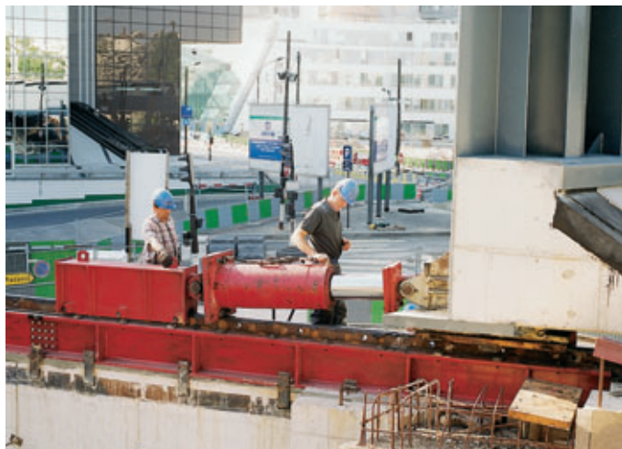
Photo 8 Système de ripage du tablier deux voies (1 500 t à déplacer!) System for shifting the two-lane deck (1,500 t to be shifted!)
