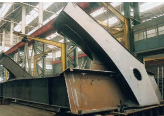
Photo 5 Montage à blanc de certains éléments de charpente à Alès Trial set-up of certain structural elements in Alès
