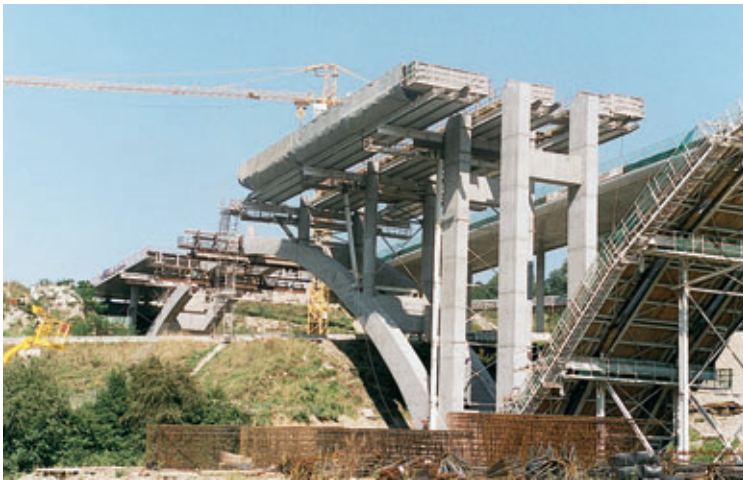
Photo 4 Equipage du tablier sur le viaduc Ouest Shuttering of deck on the west viaduct
