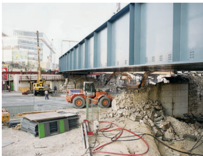
Photo 10 Démolition sous le tablier deux voies en cours de ripage Demolition under the two-lane deck during shifting
