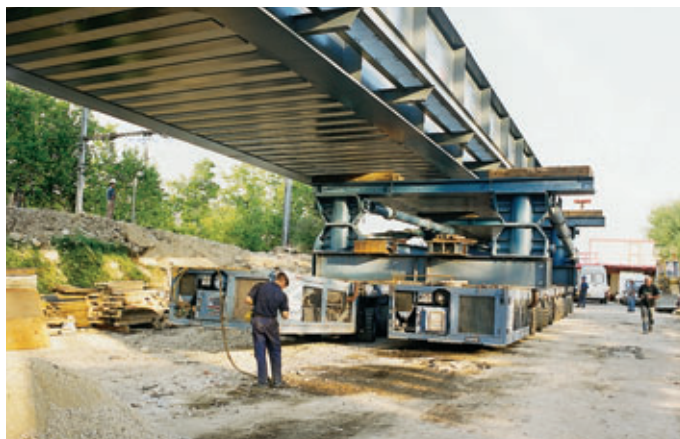
Photo 9 Manutention du tablier une voie par chariot "Kamag" Handling of single-lane deck by "Kamag" truck
