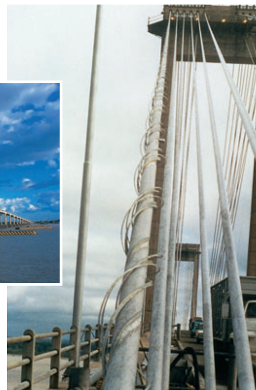
Photo 2 Etat d'un hauban avant remplacement Stay cable condition before replacement
