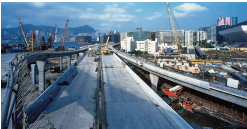
Photo 4 Vue de l'ouvrage après pose des tabliers View of structure after the placing of decks
