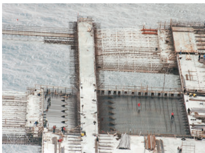
Photo 5 Exécution de la dalle du tablier : vue des cintres-coffrants Execution of deck slab : view of travelling segments
