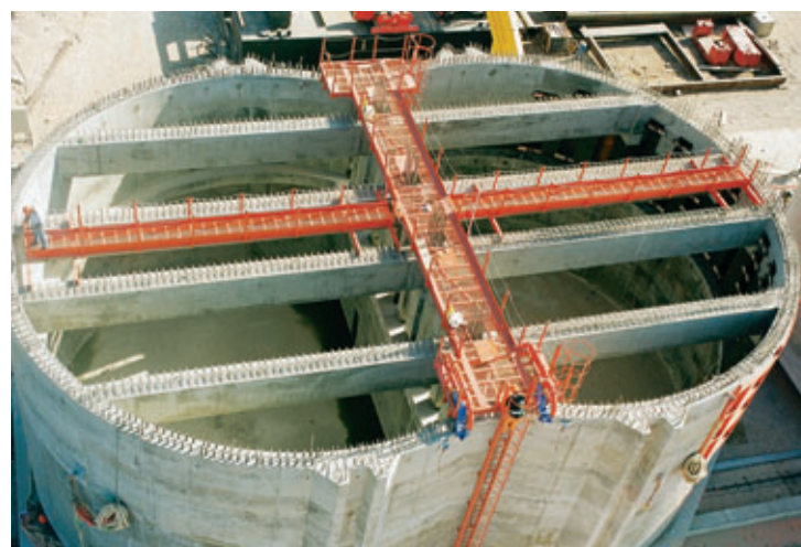
Photo 1 Le caisson terminé avant la mise à l'eau The treated caisson before sinking
