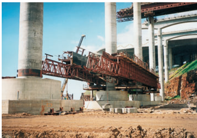
Photo 4 Transfert d'un cintre auto-lanceur entre deux travées Transfer of a travelling segment between two spans
