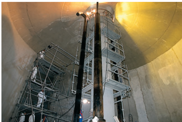
Photo 2 Travaux d'étanchéité de l'intérieur de la cuve Waterproofing work inside the tank
