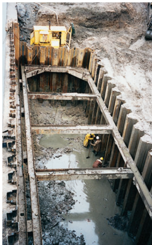
Photo 1 Vue du batardeau rive droite. Terrassements en cours jusqu'au 2 e lit de buton. En premier plan, vue du dispositif "double lierne" contre les chocs de bateaux View of right bank cofferdam. Earthworks in progress up to the second row of struts. In foreground, view of the double fender waling against boat impacts
