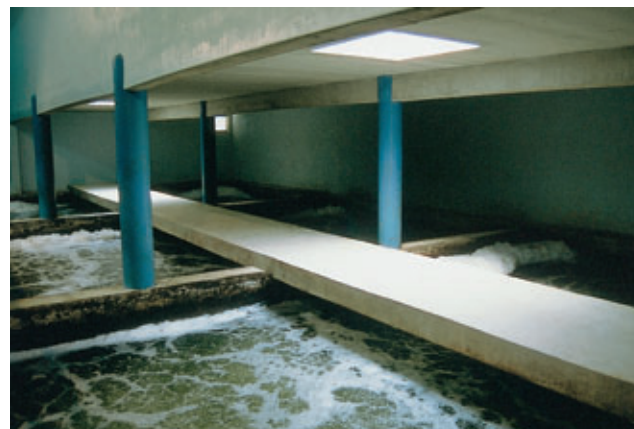
Salle des filtres Biostyr® Biostyr, filter room
