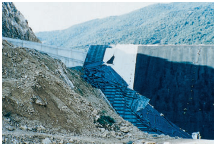
Photo 4 Membrane arrachée par le vent Wind-torn membrane
