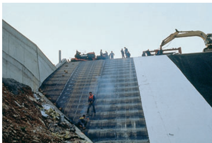
Photo 2 Soudage des lés (de gauche à droite : la géomembrane, le géotextile, la couche support)
