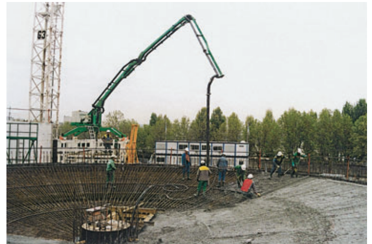
Photo 4 Bétonnage d'un plancher avec un Cicmat 3.14 Concreting a floor with a Cicmat 3.14
