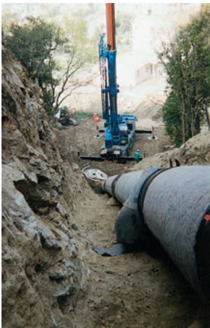
Photo 3 Pose de canalisations dans des zones très pentues Placing of piping in steep slope zones
