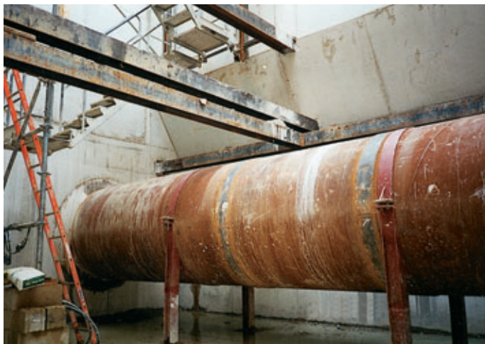
Photo 3 Chambre Surmelin avec "patte d'éléphant" réalisée pour s'affranchir d'un ouvrage d'assainissement Surmelin chamber with "bell-bottom" provided to obviate a drainage structure
