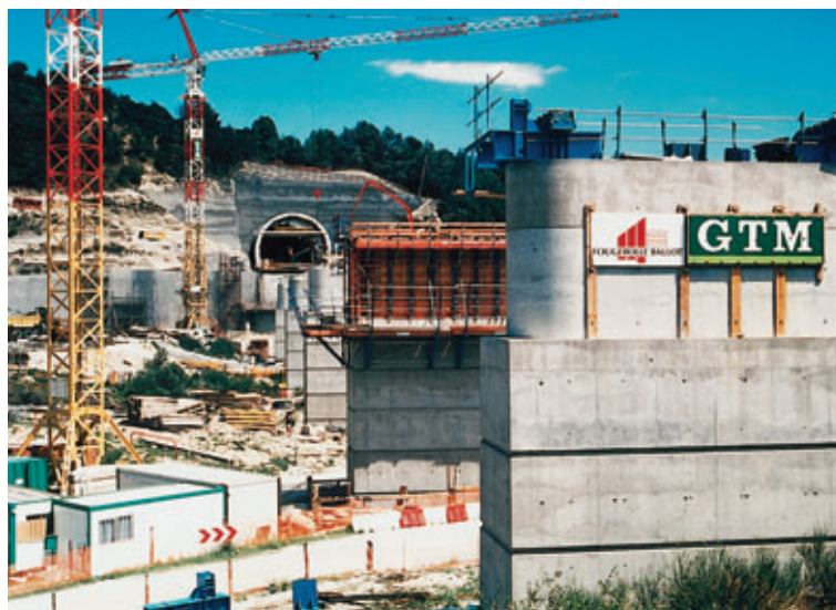
Photo 1 Vue d'ensemble viaduc et tunnel depuis l'ouest Overall view of viaduct and tunnel from the west
