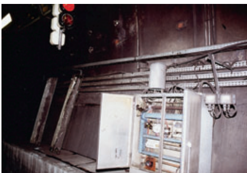
Photo 4 Une alimentation électrique à rénover Electric power supply to be reconditioned
