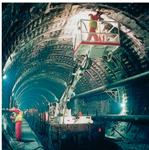
Les passerelles de service The service gangways
