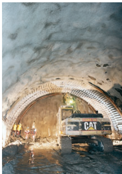
Photo 3 Mise en place des cintres de soutènement en zones de mauvaise tenue
