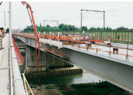
Photo 8 Équipage mobile en position pour le bétonnage d'un plot Travelling formwork in position for concreting
