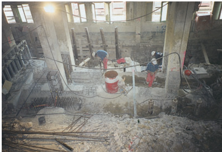
Photo 3 Travaux de génie civil au 4 e sous-sol. Ouvrage de transfert de charges, longrines, micropieux avant recépage Civil engineering work on fourth basement. Load transfer structure, footings, micropiles before strike-off
