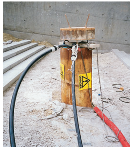
Photo 4 Tête de puits d'écumage. Parvis Stade de France Skimming shaft head. Stade de France court
