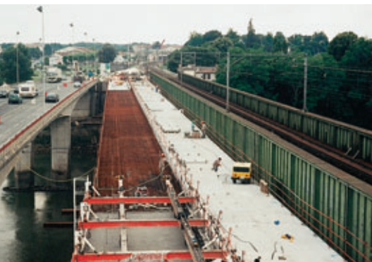
Photo 7 Réalisation du hourdis sur tablier V2 Completing the tile blocks on deck V2
