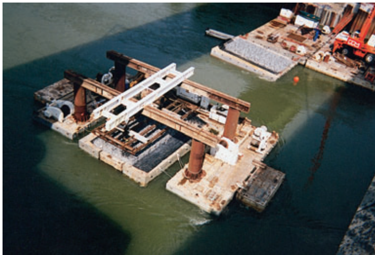
Photo 4 Pontons pour mise en place des gabions Pontoons for the setup of cribs
