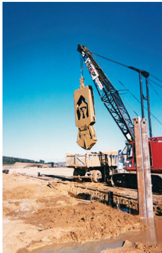
Photo 6 Val de Reuil : le forage à la benne Val de Reuil: drilling work with bucket
