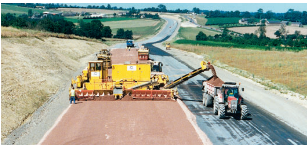
Photo 3 Autograde de type Guntert-Zimmerman équipé du système de guidage Agtek. Découpe de la GRH Guntert-Zimmerman autograde at work
