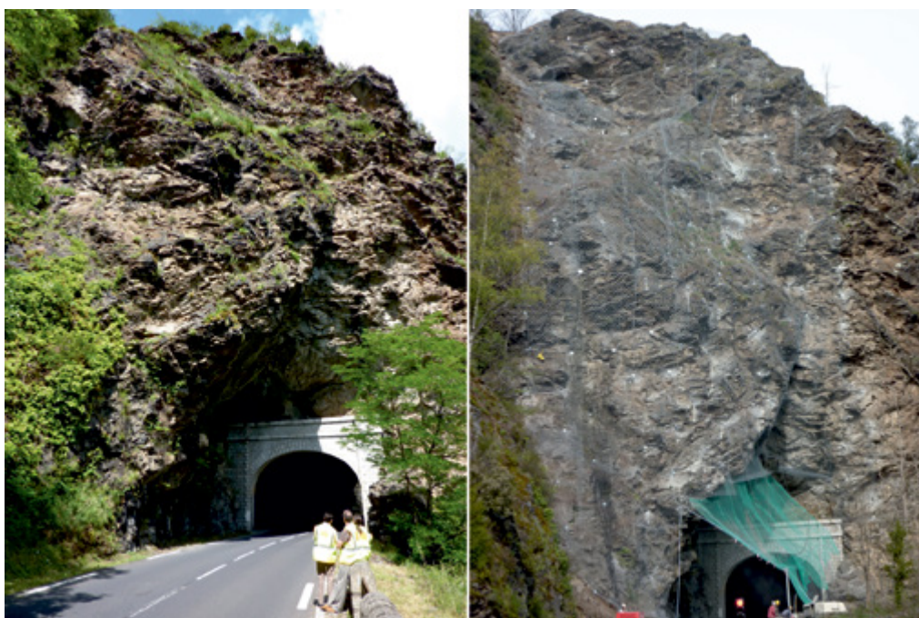
Figure SC4.1 Zone de sécurisation par grillage plaqué, avant et en fin de travaux – Prats-de-Mollo (Pyrénées Orientales)
