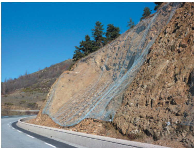
Figure DE1.1 Grillage pendu avec piège à cailloux – Virage du Pallat – RN 116 (Pyrénées Orientales)
