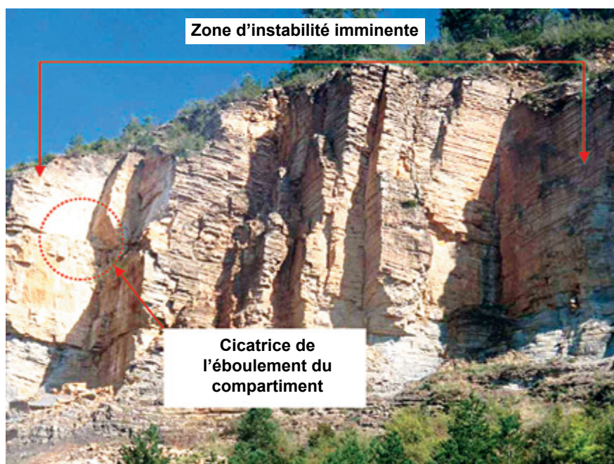
Figure Cas8.3 Zone d'instabilité imminente avec la cicatrice de l'éboulement d'octobre 2006
