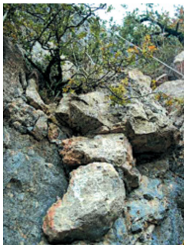
Figure Cas7.2 Blocs instables de 0,3 \text{ m}^3 à purger manuellement
