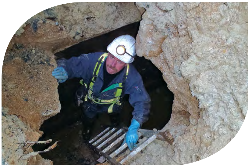
Effondrement de l'ouvrage par la voute DEA CD 93
