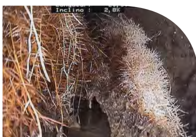
ITV montrant la présence de racines et l'obstruction du réseau
