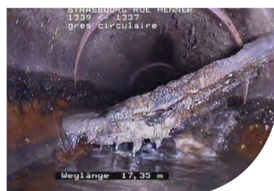
ITV montrant la présence d'une conduite étrangère en travers du réseau Eurométropole de Strasbourg
